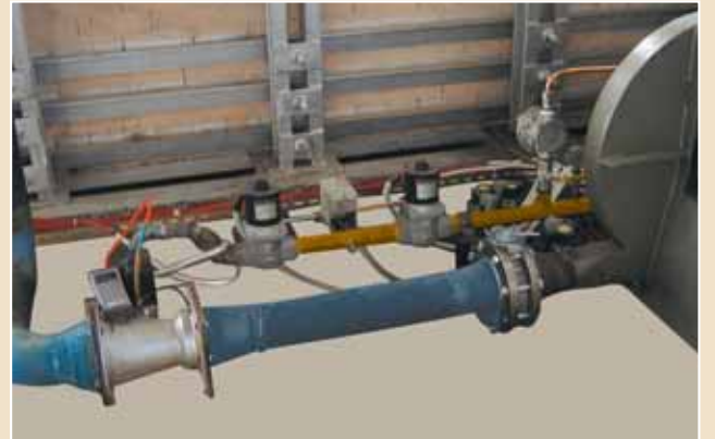
Premix gaz ve hava hattı Premix gas and air line
