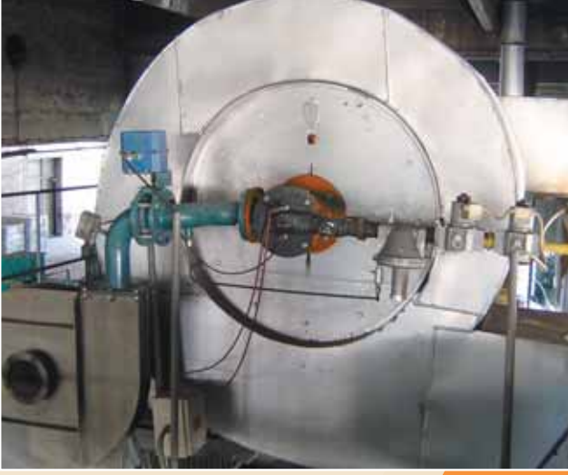
Sıcak hava jeneratörü Hot air gas generator
